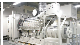
非常用発電機
