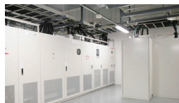
無停電電源装置 (UPS)
